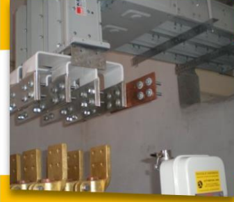
Diyarbakır Hipodrom Gece Koşusu Aydınlatma ve Trafo Montajı ve Yeraltı Kablo Montajı
