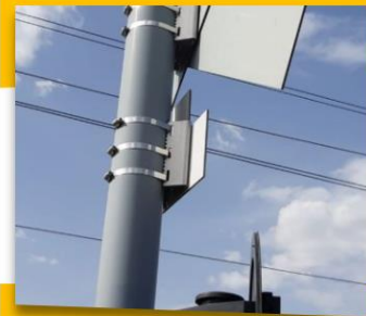
Eskişehir-Kütahya Tavşanlı Demiryolu Bariyer Korumucu İşi
